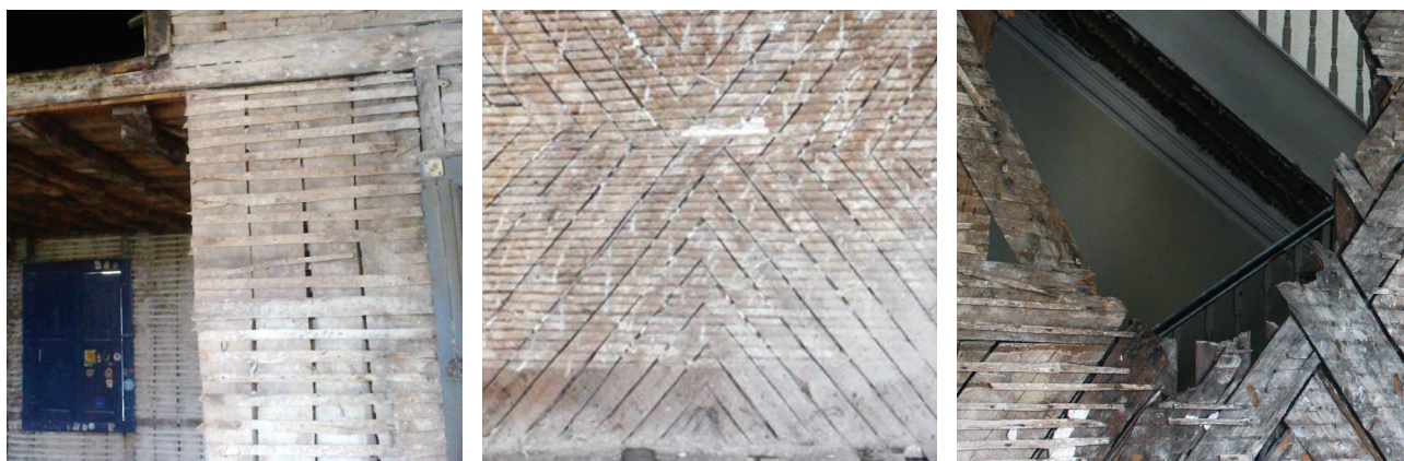
Figura 2 Parede de tabique simples e tabique duplo (sem o fasquio e pormenor de uma zona em rotura onde se percebe a existência do duplo tabuado)
