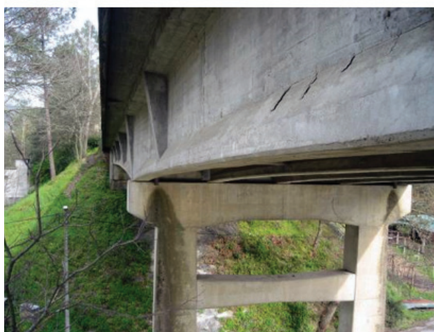
Figura 3 Esmagamento de aparelho de apoio em chumbo e delaminação do betão na viga do lado norte
