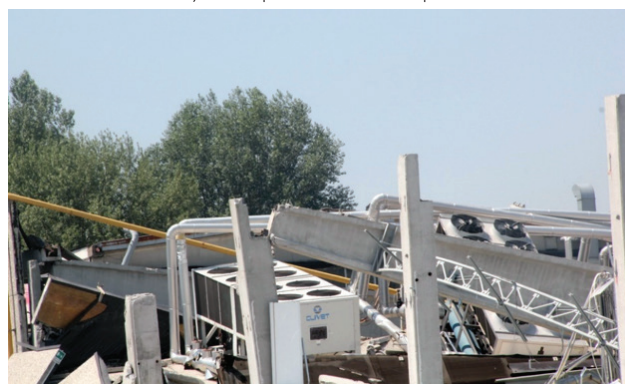
b) Dano devido à falta de suporte de vigas
