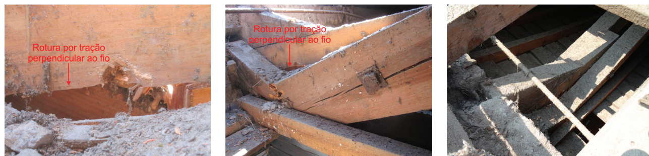
Figura 5 a) Rotura da peça central b) Rotura da ligação; c) Vista de topo do apoio colapsado
