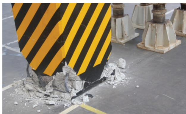
a) Rótula plástica na base do pilar
