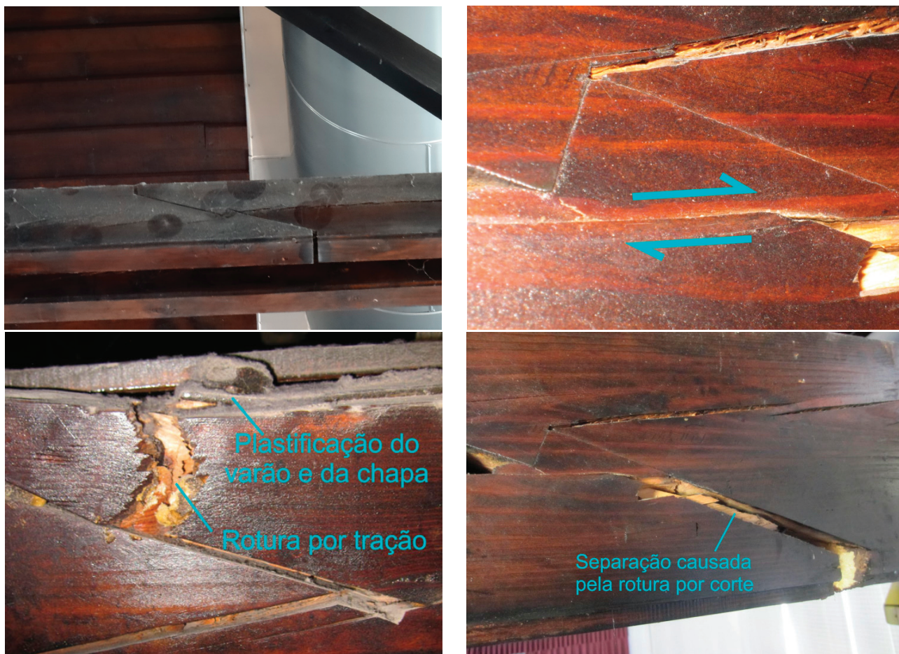
Figura 6 a) Vista geral; b) Rotura por corte; c) Plastificação do ligador; d) Abertura da junta
