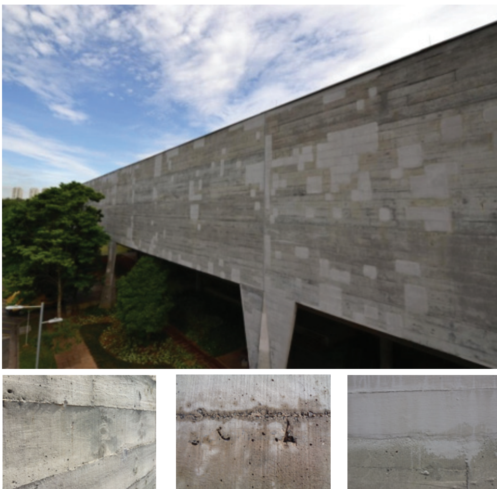
Figura 3 Acima: fachada sudoeste do edifício Vilanova Artigas. Abaixo à esquerda e ao centro: aspectos do concreto original da fachada. À direita abaixo: detalhe de um reparo realizado com argamassa industrializada na campanha de 2012-2015 (Fotos: Acervo equipe ConservaFAU, 2017)
