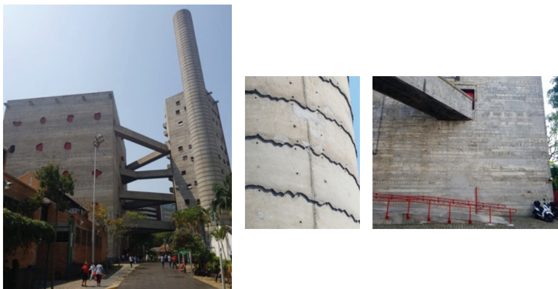
Figura 4 Conjunto esportivo do SESC Pompéia. À esquerda: vista geral das duas torres que abrigam a circulação, serviços, quadra poliesportiva e conjunto aquático e a torre do reservatório de água. Ao centro: detalhe da superfície do reservatório de água com um reparo localizado. À direita: superfície com reparos pontuais feitos com argamassa industrializada (Fotos: Tatiana Simão, 2018)
