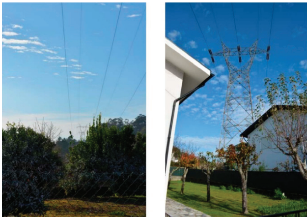
Figura 1 LRA.VM1: a) vão e b) poste instrumentado
