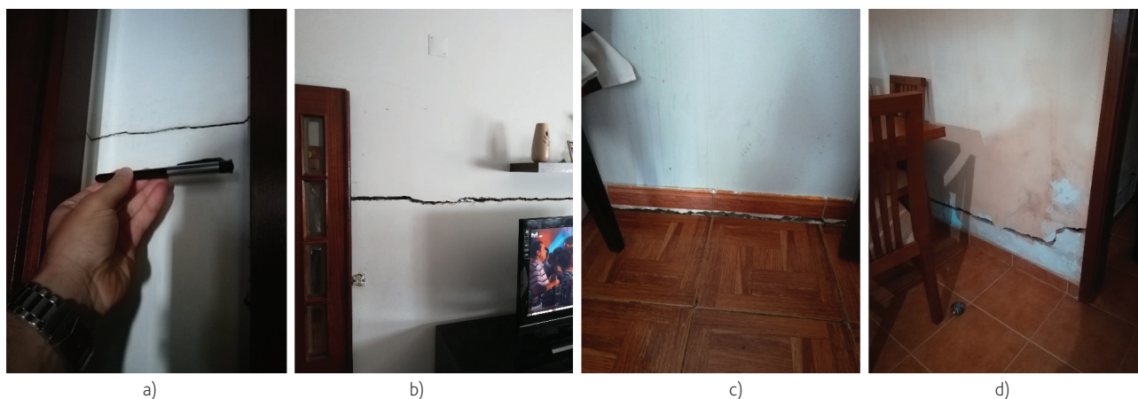
Figura 4 Patologias/danos interiores do edifício em estudo: a) fissuração horizontal; b) fissuração horizontal; c) abatimento do pavimento; d) fissuração horizontal
