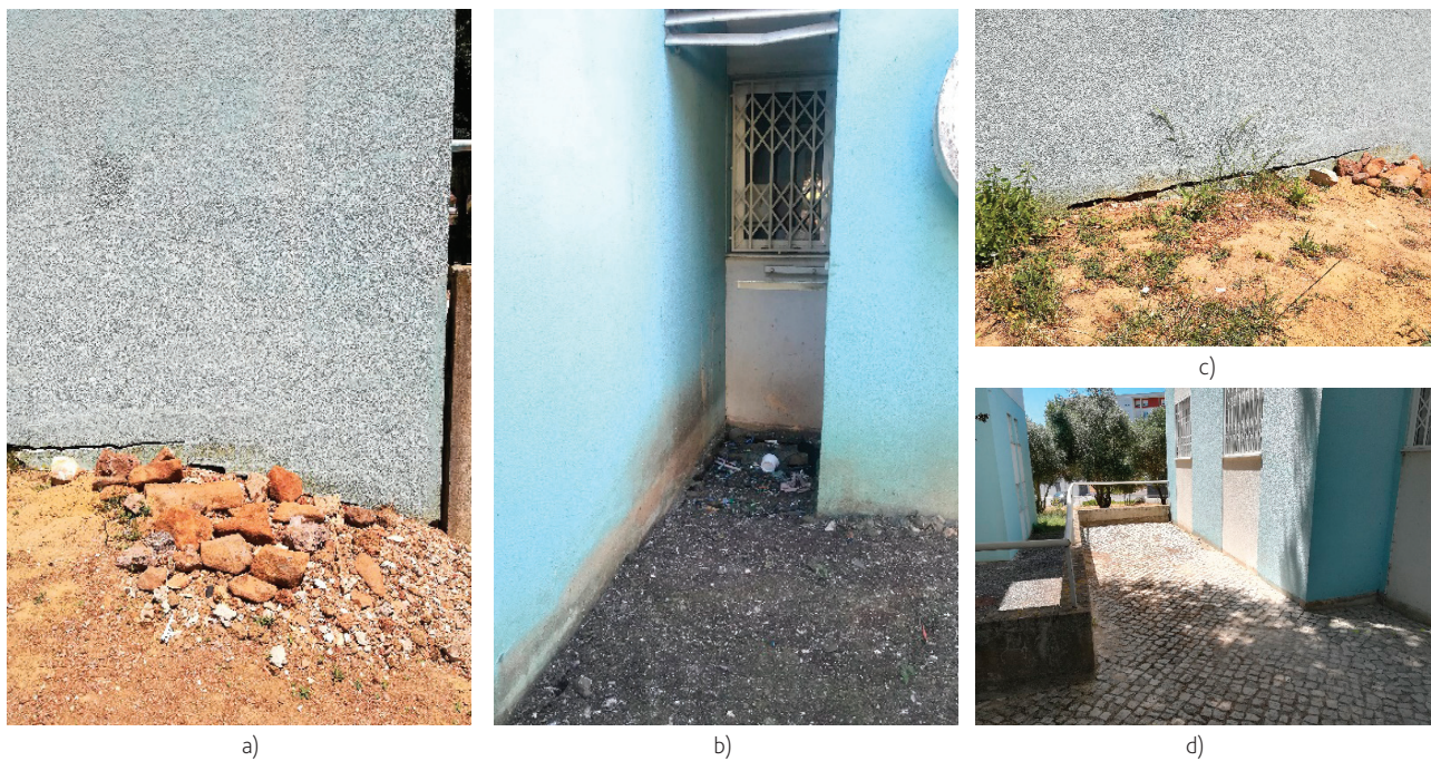
Figura 3 Patologias/danos exteriores do edifício em estudo: a) destacamento do muro; b) assentamento dos pavimentos; c) fenda horizontal na fachada; d) assentamento dos pavimentos
